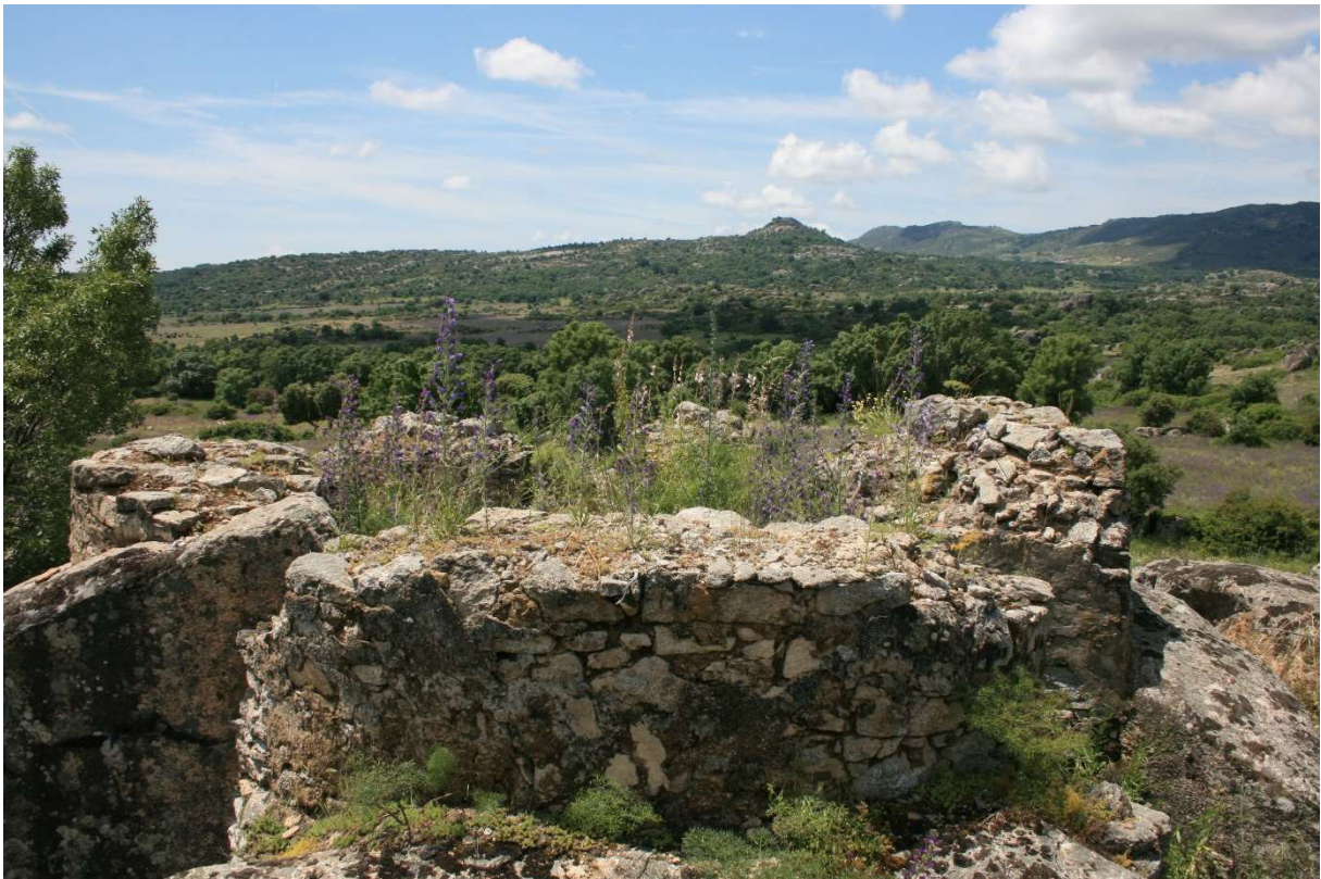
Figura 117. Emplazamientos de morfología circular (s.l.) de Los Picoruchos (PCH-019: RCH/r): Obra de mampostería con cemento y acceso trasero, orientado al NNO. Presenta 3 troneras, con reborde de ladrillo y rediente escalonado, orientadas hacia el OSO/S/SE. Hay una especie de chimenea tallada dentro de la pared trasera, que sale de lo que parece un armario de munición, atraviesa el muro con inclinación de 45º y parece salir al exterior y está revestida, interiormente, de ladrillo. Puede tratarse de un aljibe, una chimenea de evacuación de humos o una tronera de lanzabombas, pero su finalidad real nos es desconocida.
