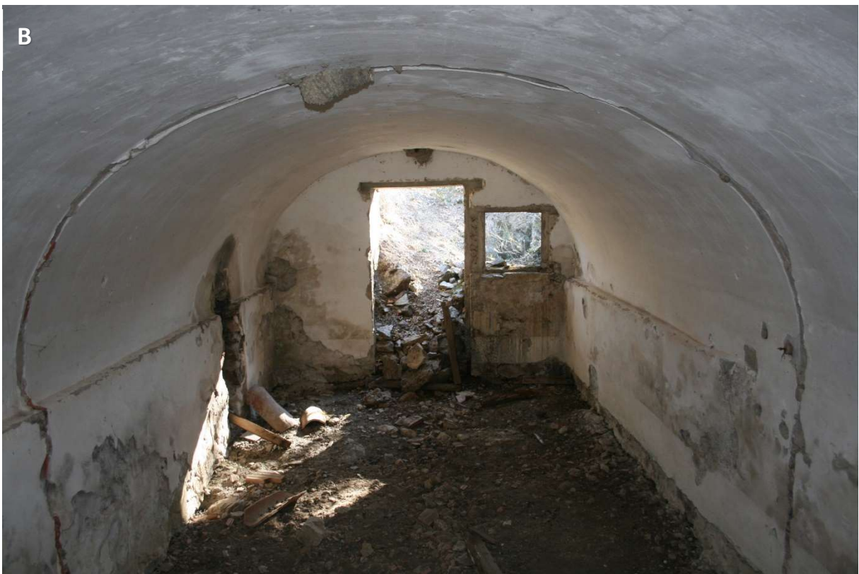
Figura 80. Abrigo blindado de Valdesequillo (V SQ-011: RCH/n). A) Obra rectangular, de 6x4,40 m, de mampostería con cemento y ladrillo y acceso por ambos lados. Desempeña funciones de alojamiento, refugio y, seguramente, PC del CoDe. B) Paredes lisas, techo blindado con bóveda de medio cañón y puerta y ventana, en cada uno de los dos lados. División original por tabique interior (desaparecido, pero obsérvese la huella del mismo en la pared). Enfoscado de yeso interior y numerosos grafitis.
